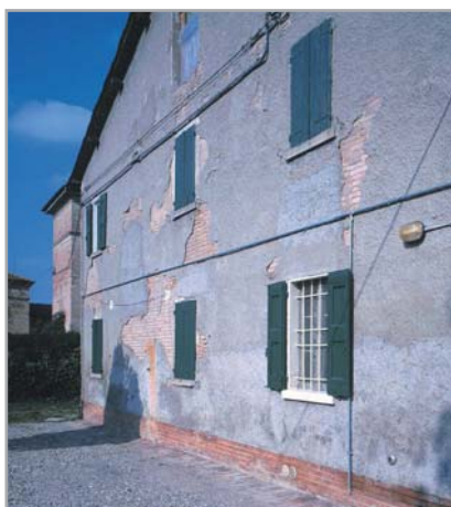
Fig. 2 - As partes de reboco em fase de destacamento devem ser removidas antes da colagem dos painéis isolantes
