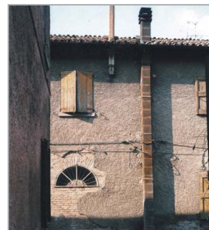
Fig. 1 - Edifício em alvenaria afetado por humidade ascendente
